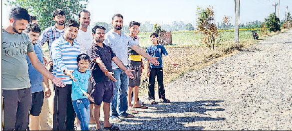
मुलाना। टूटी सड़क दिखाते ग्रामीण।
